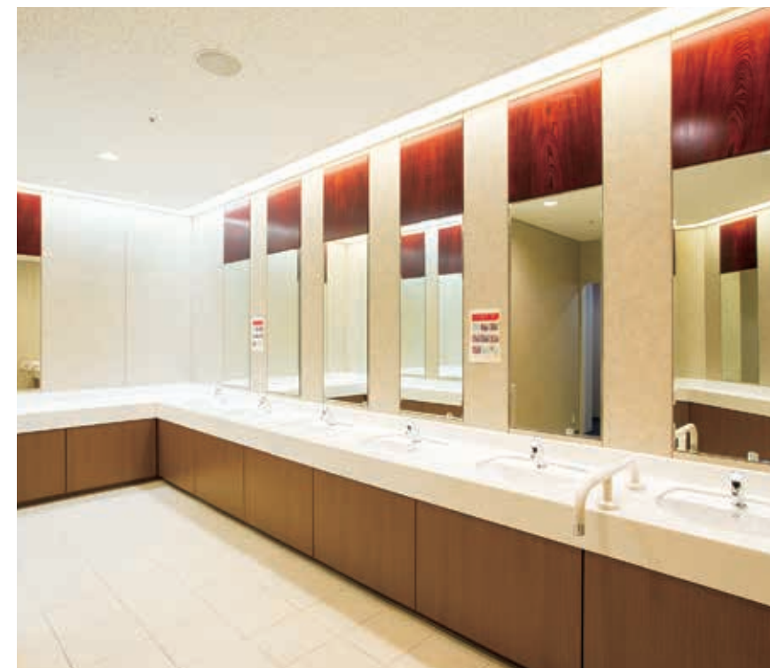
工事名：福井駅東口再開発ビル (アオッサ) 内 容：衛生機器納入 完 成：平成19年
