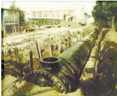
非常用貯水装置(ダグタイル管)昭和57年(1982) 敷設の福井市順化小学校のもの(福井市初)
